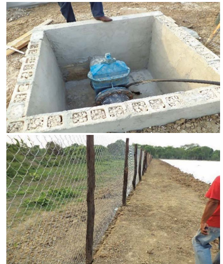
Figura 4. Válvula de paso hacia el depósito (arriba) y Cerco perimetral de la cuenca de captación (abajo).
