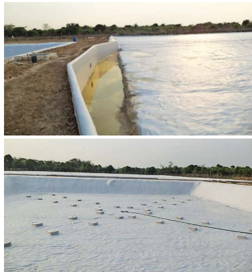
Figura 3. Área de captación de agua de lluvia (arriba) y Olla de almacenamiento recubierta con geomembrana (abajo).
